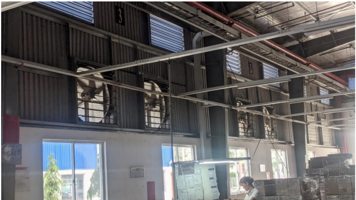
Hình 4. 2. Hệ thống quạt để thông gió nhà xưởng của dự án
