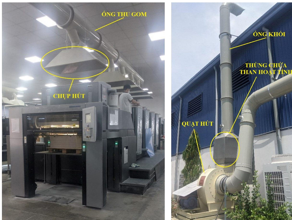
Hình 4. 4. Hình ảnh hệ thống chụp hút thu gom và xử lý hơi dung môi
