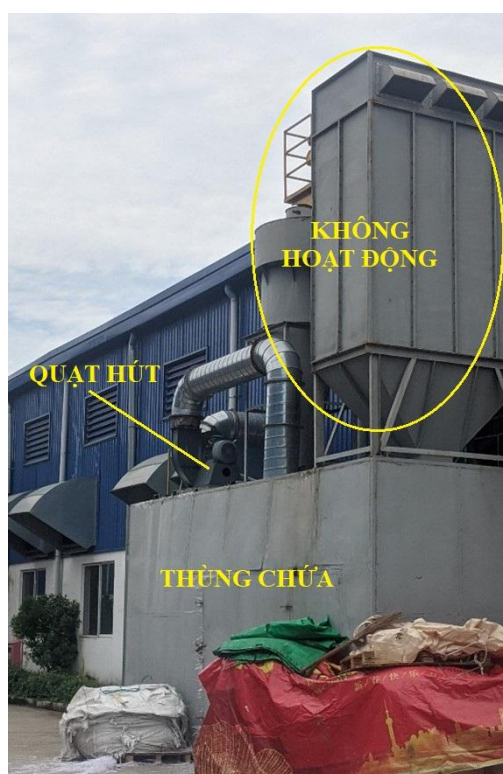
Hình 4. 14. Hệ thống thu gom giấy vụn từ công đoạn cắt giấy
