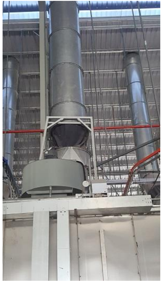
Ống thoát hơi dung môi của bồn sơn màng nước
