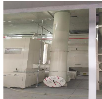
Đường ống dẫn bụi về cyclone
