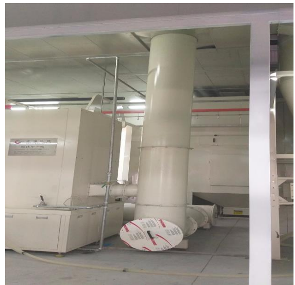
Đường ống dẫn bụi về cyclone
